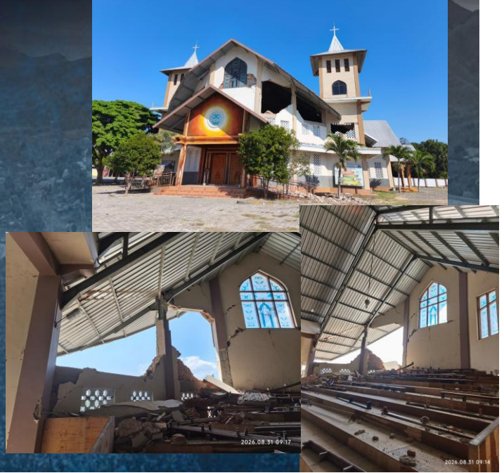
Kondisi Bangunan pada Tanah
